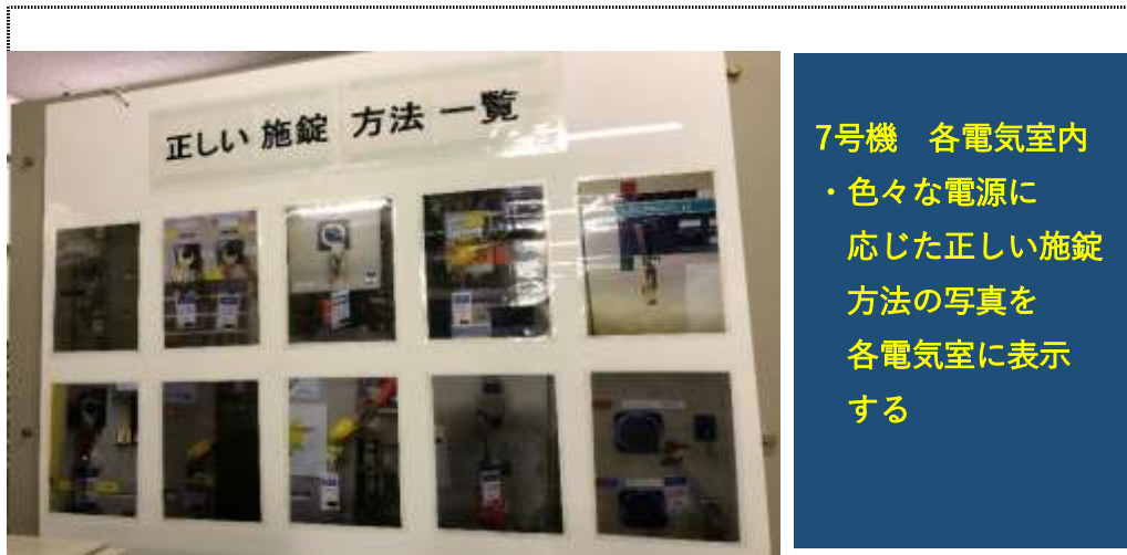
セクショナル電気室内表示
