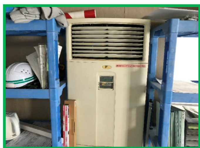
現場詰所にエアコン付き完備
