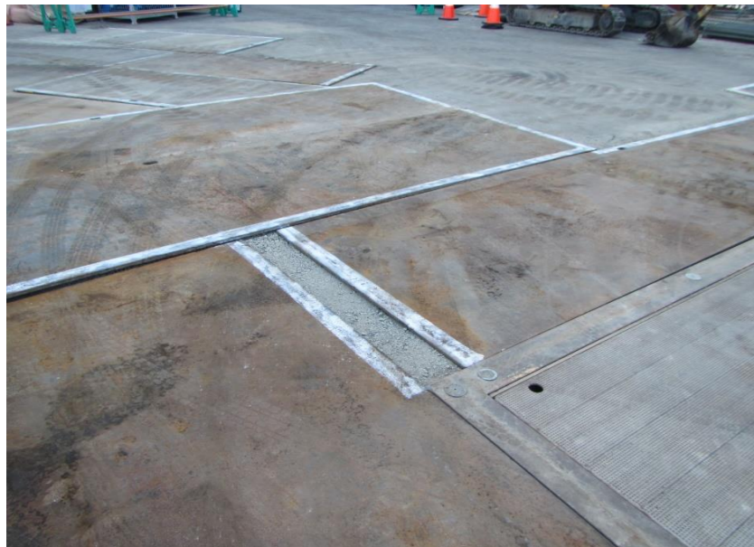
④鉄板段差明示
