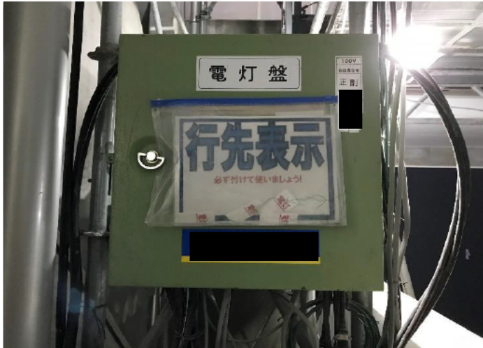
分電盤の回路行先表示カードの掲示の様子
