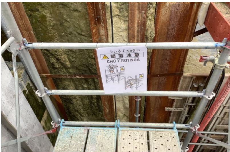
足場 墜落注意
