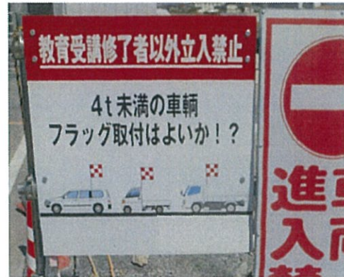
構内入口にフラッグ取付の注意看板
