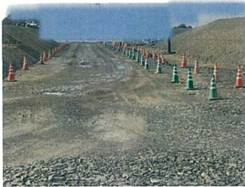
普通車輛が通る箇所の安全通路
