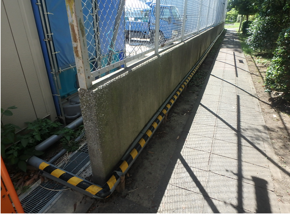
排水管部のトラテープの明示
