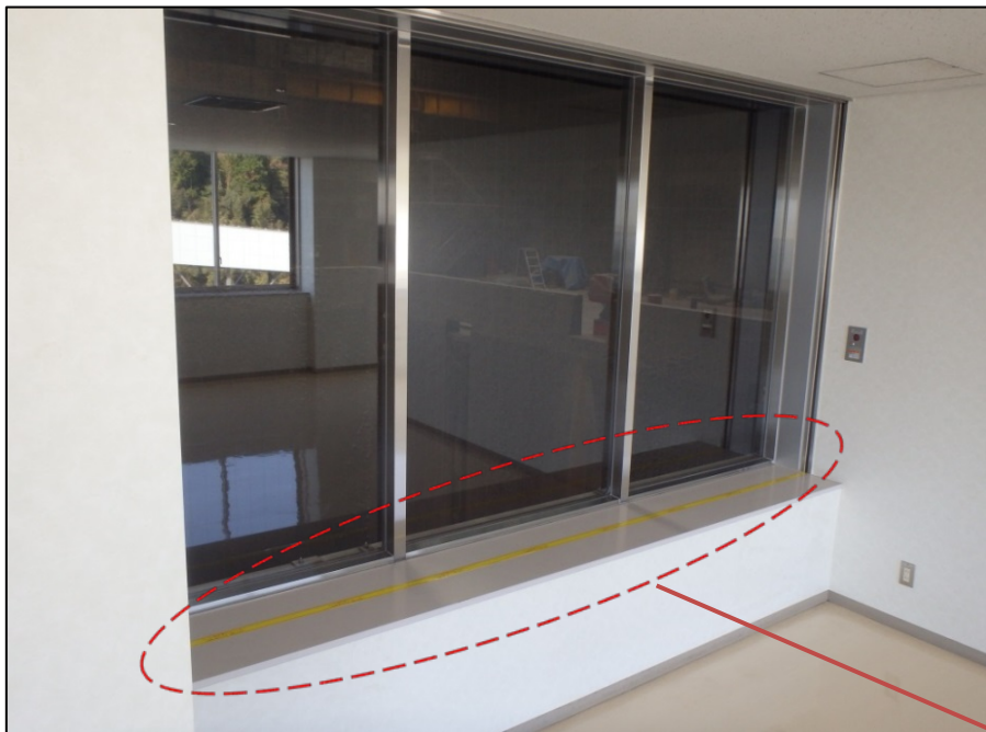
火災時に防火シャッターが作動する箇所
