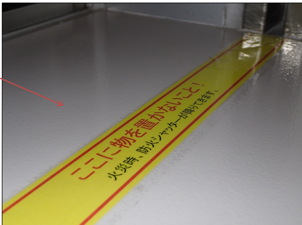
防火シャッター降下位置に「ここに物を置かないこと！」の注意表示
