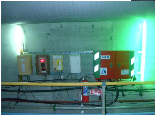
綠色:消火器+非常警報器+坑内電話
