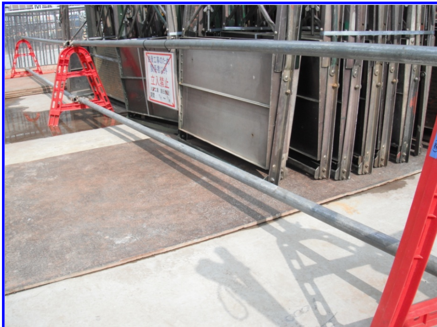
立入禁止区画の明示 (区画看板の掲示と赤色バリケードの使用)
