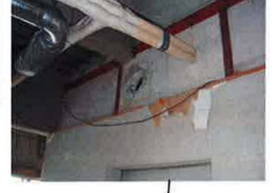
電気鍵配線: 注意表示(表示)
