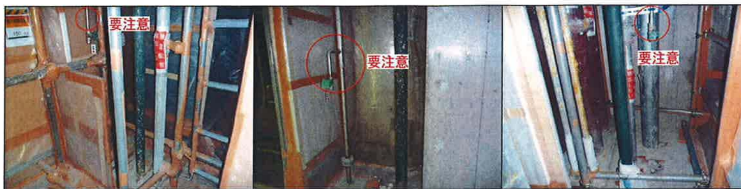
湯沸室：活給水管
