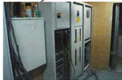
分電盤: 充電部養生+注意表示
