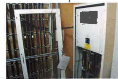
分電盤: 充電部養生+注意表示
