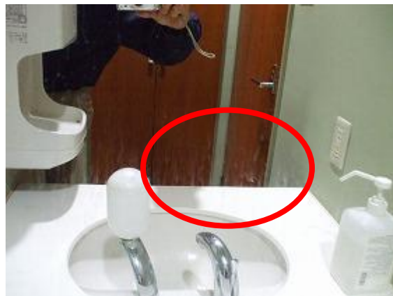
洗面所ガラスの汚れ(1Fトイレ)
