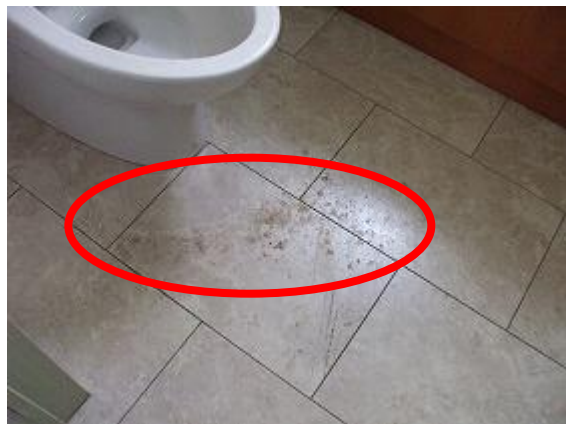
トイレ(個室)の床の汚れ(1Fトイレ)
