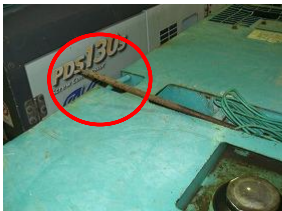
アースの棒の先端がはみ出ており危 険(レンタル2F)
