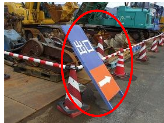
看板が立て掛けてあるだけの状態 (敷地内)
