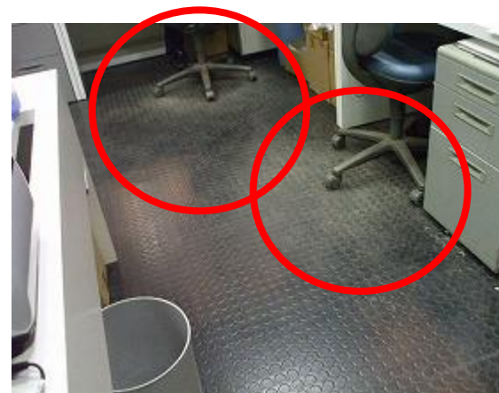
フロント内部の床が白い(1F)
