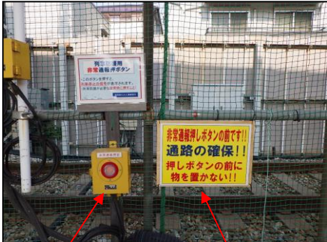
非常通報押ボタン
