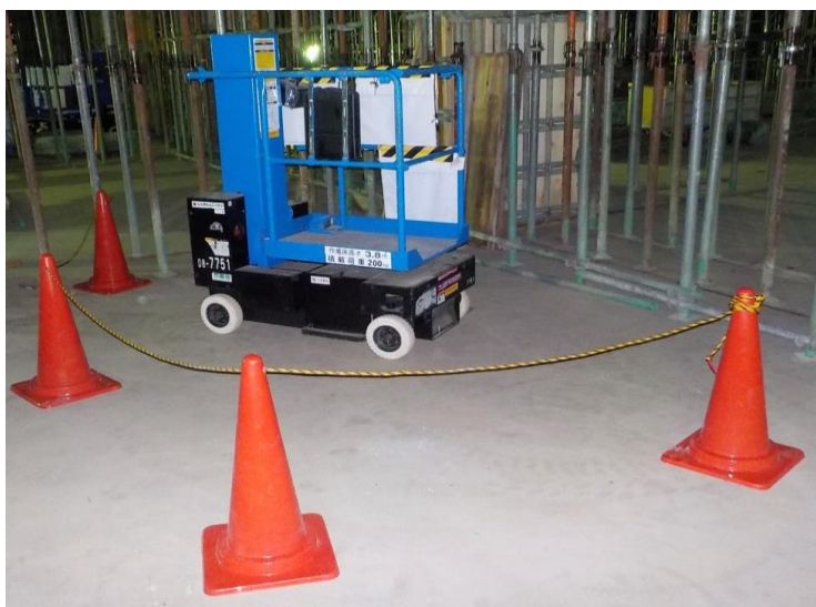
【改善後設置状況】
