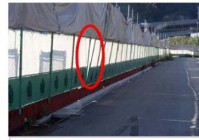
× Bフェンの固定が外れているので直す事
