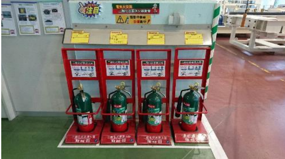
①消火器の保管場所
