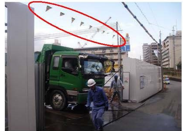
「ジャバラゲートの場合、上空制限注意」表示
