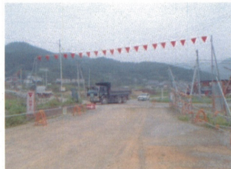
交差点部では一旦停止津波資料館周辺では見学者に注意
