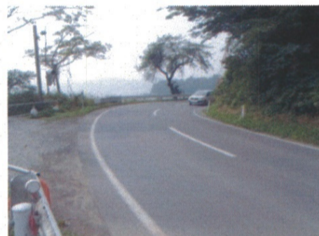
護岸工上部展望台付近道路は見通しが悪い。対向車に注意
