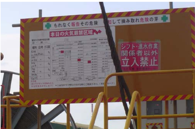
危険作業区画の表示
