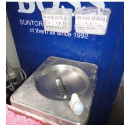
熱中症対策冷水機・塩設置
