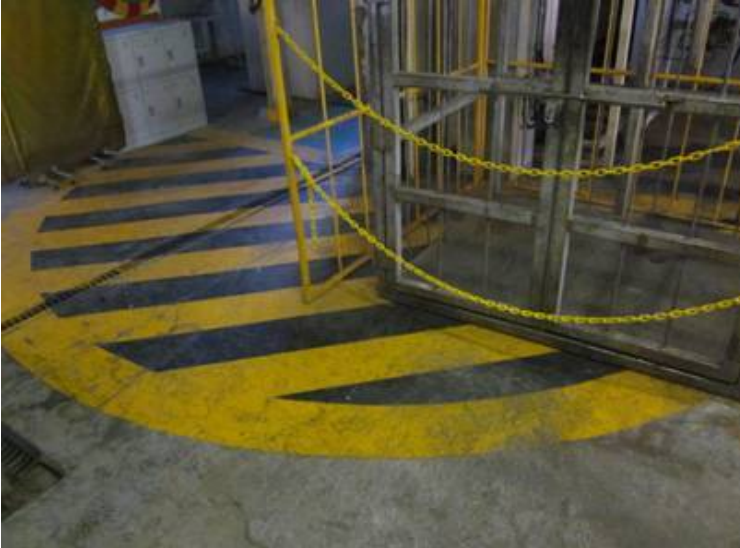
①昇降する柵の周辺の床にトラ柄のペイントを塗装
