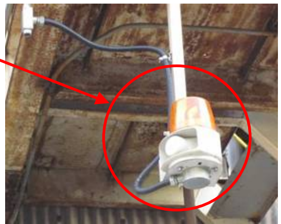
昇降時はパトランプが点灯
